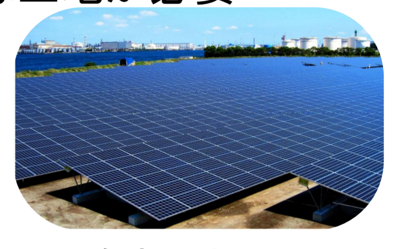
扇島太陽光発電所
